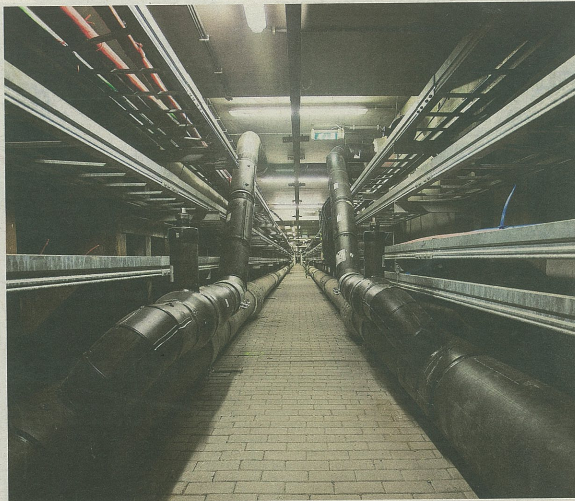
Diep onder de grond ligt het leidingenstelsel van de Amsterdamse Zuidas. FRANK GROELIKEN
